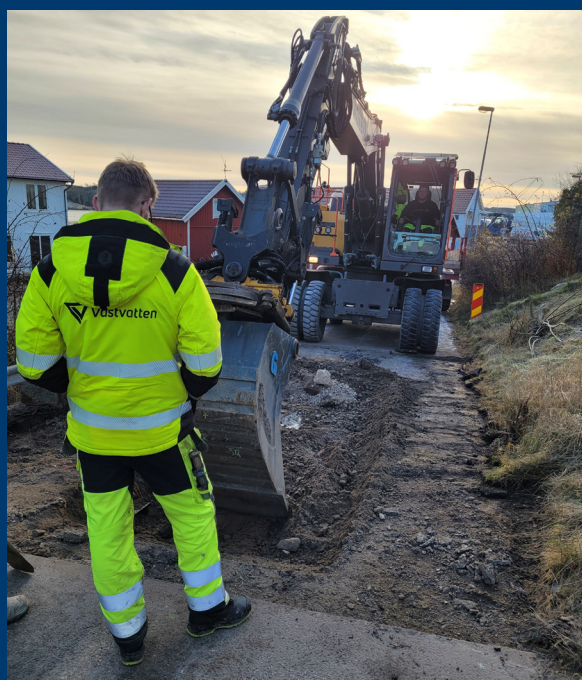
Åtgärder vattenläcka på Hovenäset. Fotograf: Victor Tånge
